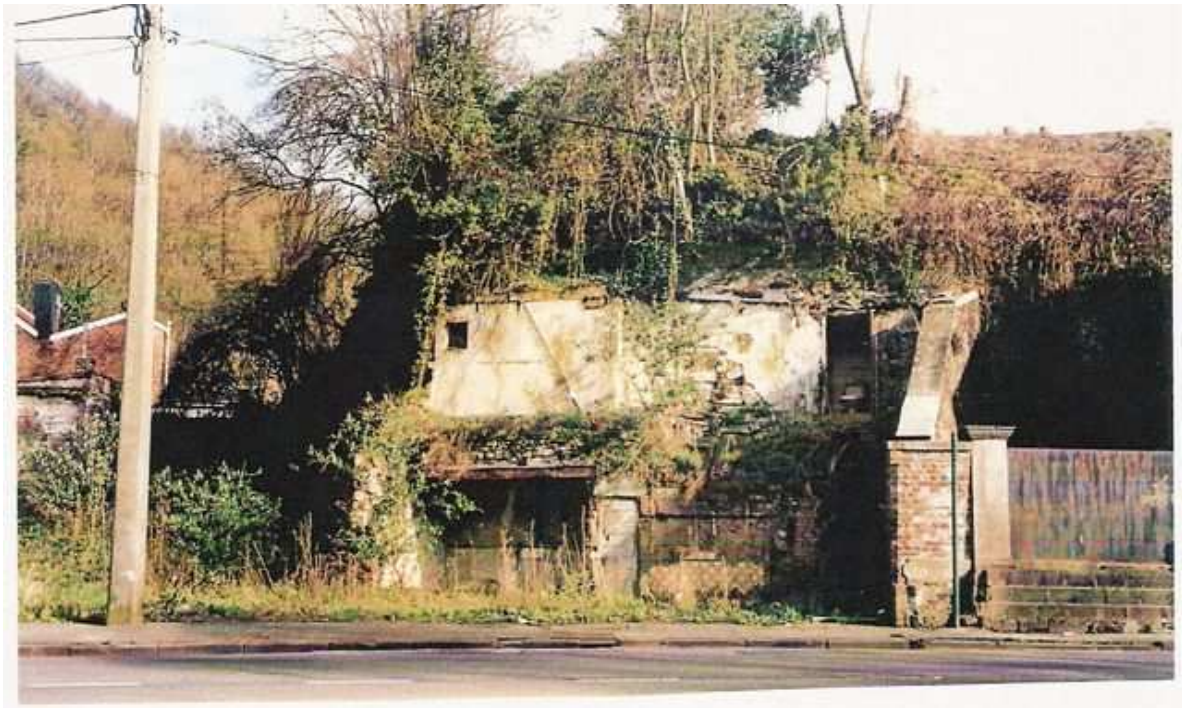
Les murs de soutènement ouest du vieux cimetière, le long de la rue Steenebruggen
