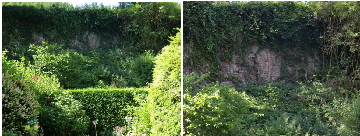
Le mur de soutènement nord dans son écrin de verdure, qui le mine progressivement
